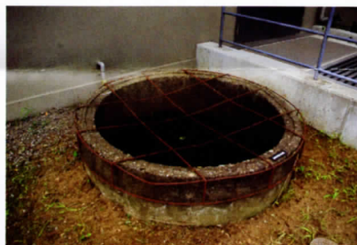
防火水槽 資料館撮影 2016年 資料館入口の脇にあります。
